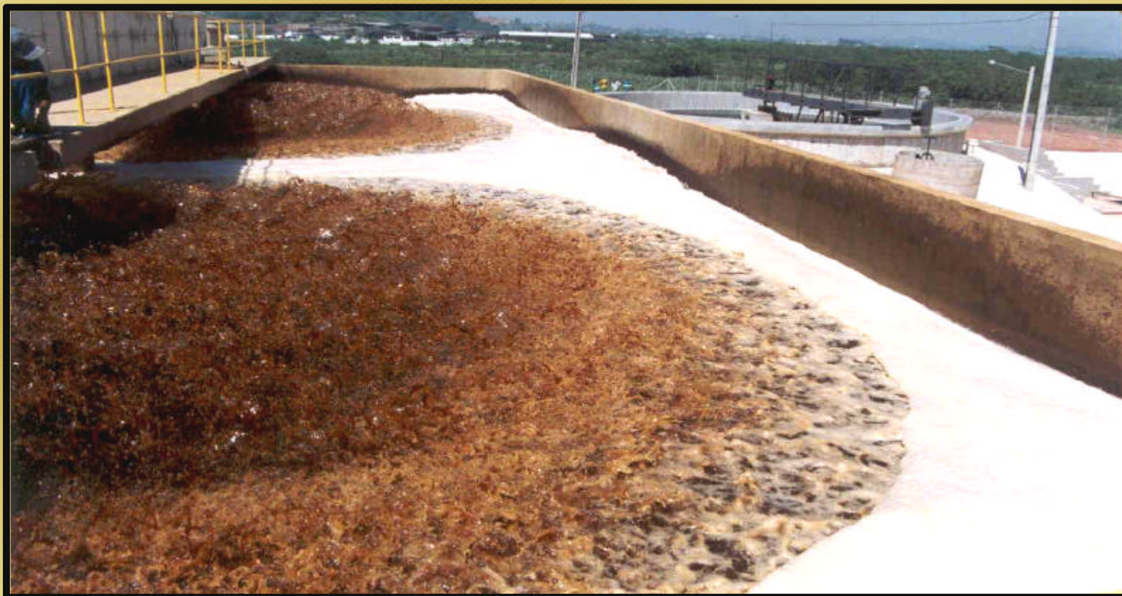
TANQUE DE AERAÇÃO
